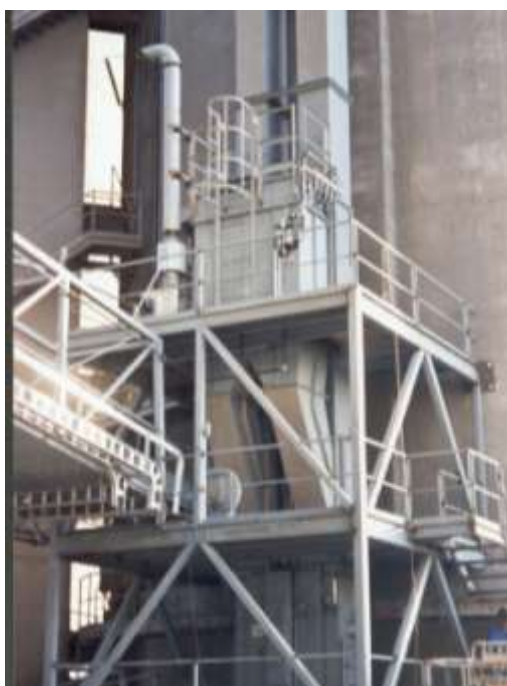
Filtro insertable en el pie del elevador.
