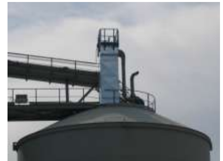
Filtro sobre silo.
