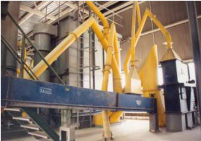
Filtros con tolva ampliada para ensacadora.
